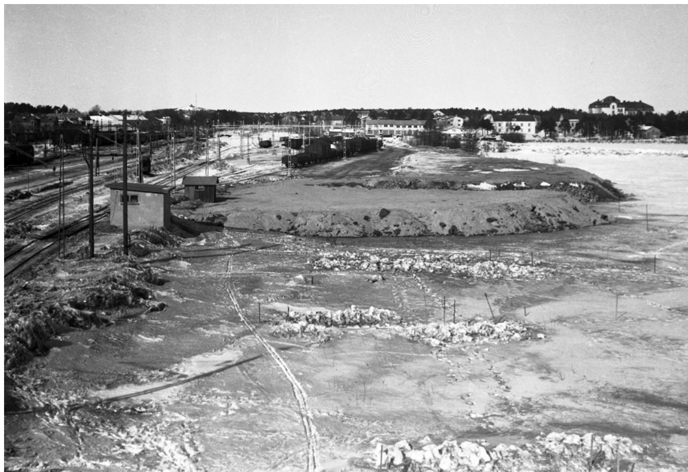
Dokumentation av arbete med att bredda spårområdet framför Järnvägsstationen och godsmagasinet år 1956. Fotograferat från Malmuddsviakukten. Foto: Helmer Widlund, Luleå kommuns stadsarkiv.
