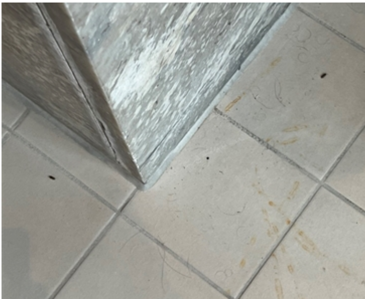
Bild 2. Krypande skadedjur på golvet.
