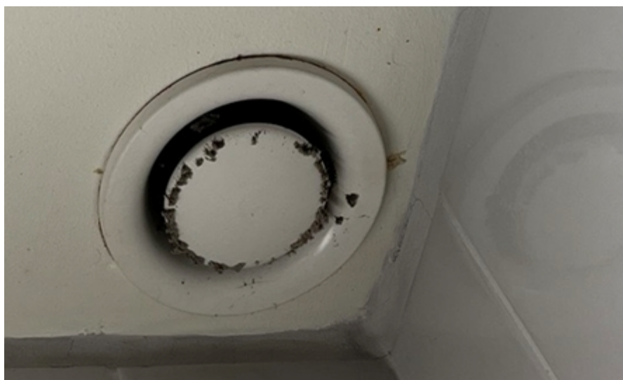
Bild 10-11. Dammiga ventilationsdon. Bild 15 är från toaletten vid utgången till bassängerna från damernas duschutrymme.
