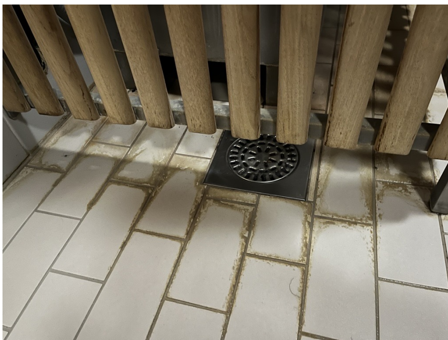
Bild 33-34. Bristfällig städning av golvet kring bastuaggregatet i damernas omklädningsrum.
