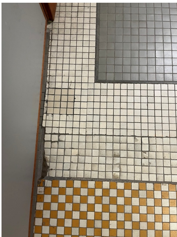
Bild 23-26. Avsaknaden av klinkerplattor/ trasiga klinkerplattor (bild 23-24: i damernas omklädningsrum och bild 25-26: kring stora bassängen).
