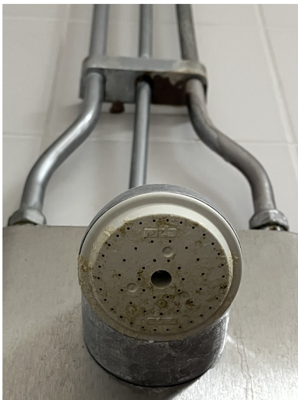
Bild 7-8. Två olika duschmunstycken i damernas duschrum.
