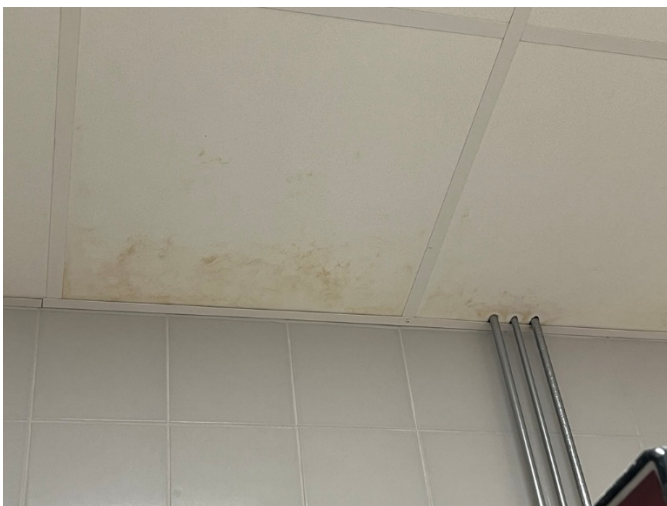
Bild 14-18. Fuktfläckar i damernas duschutrymme.
