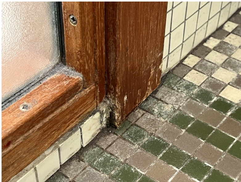
Bild 29-32. Bristfällig städning kring dörrkarmar både mellan damernas omklädningsrum och damernas duschrum (bild 29-30) samt mellan damernas duschrum och ut till bassängerna (bild 31-32).
