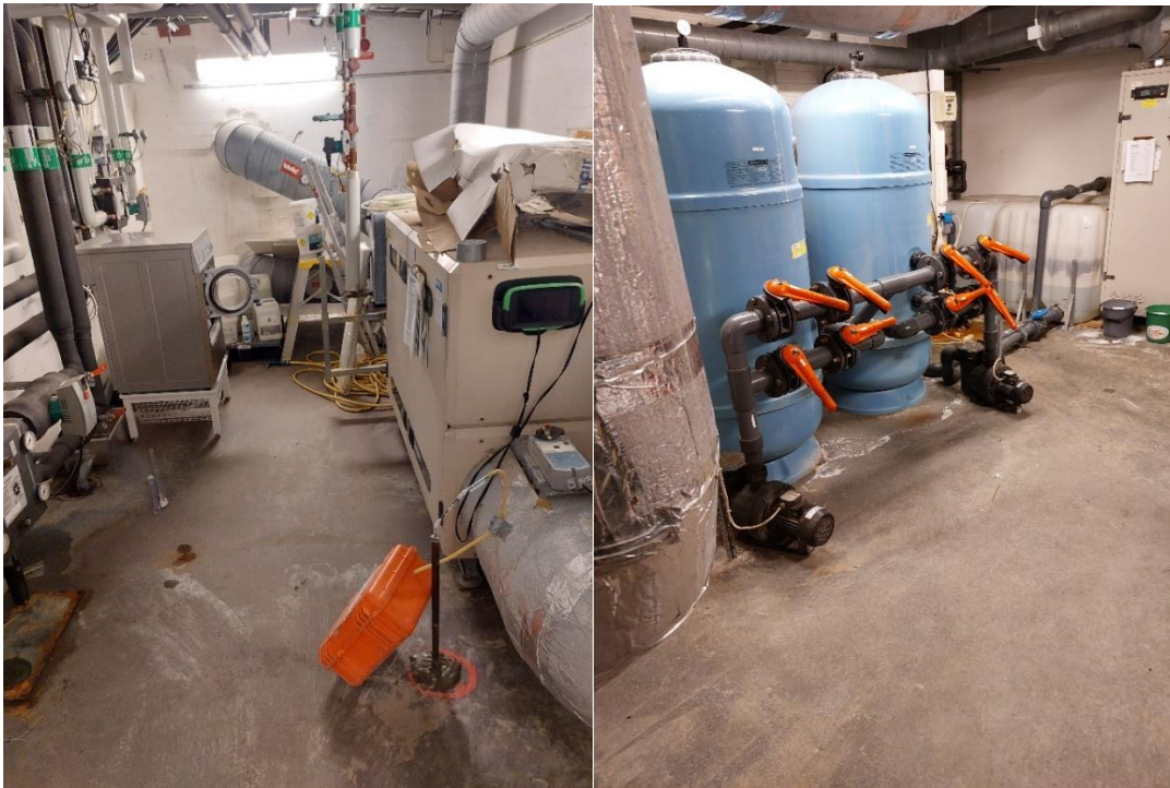
Figur 4. Bild till vänster visar teknikrummet där mätning pågår i provtagningspunkten 23W01. Bild till höger visar teknikrummet som ligger i anslutning till rummet där 23W01 är lokaliserad och där lukt av klor noterades som troligen härrör från den spaverksamhet som bedrivs i intilliggande lokaler.
