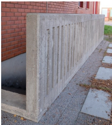
Fig 42. Betong-element, flertalet i dåligt skick.
