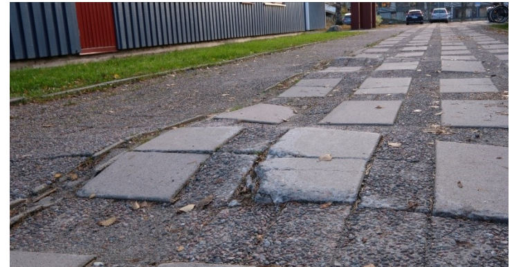
Fig 46. Markbeläggningen är i stort behov av underhåll efter tjälskador. Grundvisionen är tydligt riktade gångstråk.
