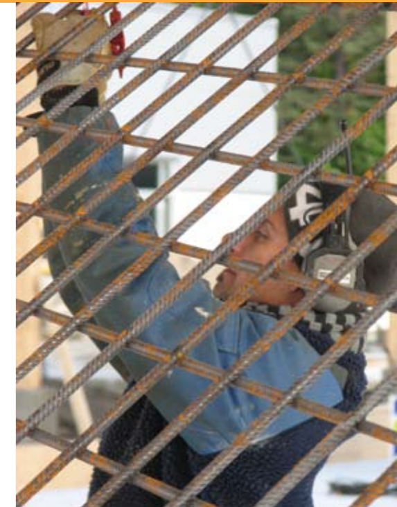
Kimmo Rousu, betong- och armeringsexpert från Näiden arbetar med att lägga armering och isolering på ispisten.
